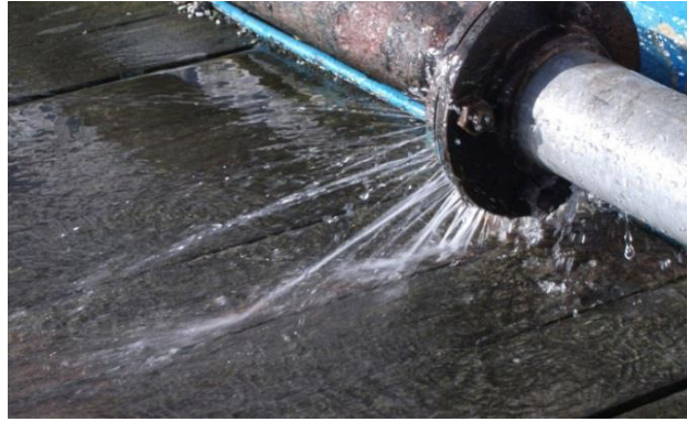
Şəkil 4.15. Kanalizasiya borusunda sızma
