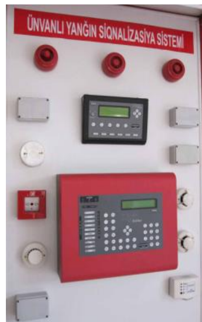
Şəkil 2.5 Yanğın siqnalizasiya sistemi
