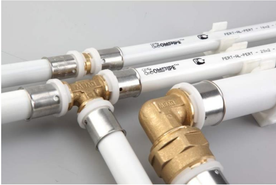
Şəkil 2.11. Sıxıcı fitinqlərdən istifadə etməklə quraşdırılmış metalloplastik su borular sistemi
