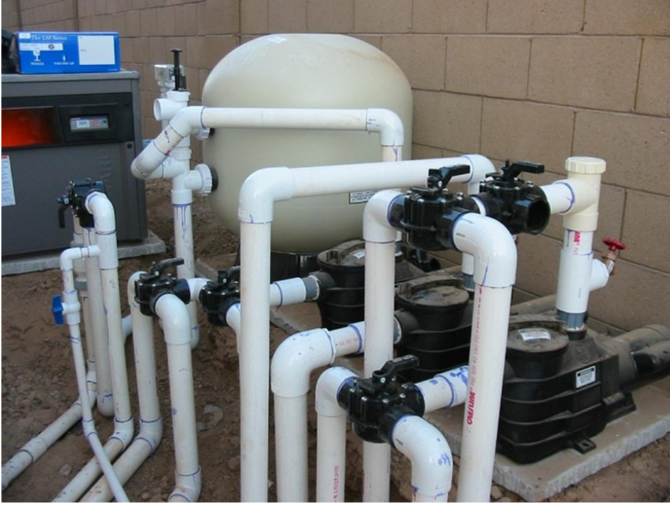
Şəkil 1.12. Şüşə lifli istiyədavamlı PPR borulardan quraşdırılmış qazanxana sistemi
