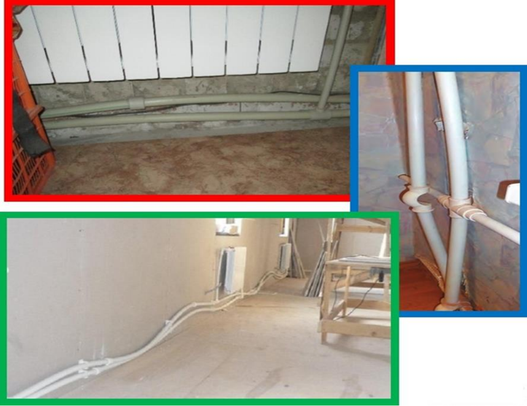
Şəkil 1.7. İstehsal markası olmayan keyfiyyətsiz borulardan çəkilmiş sistemlər
